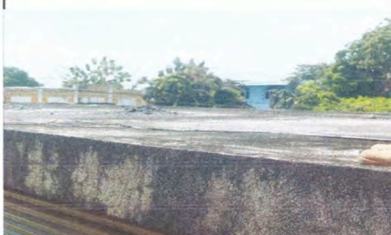
Foto 4: La terraza del salon de usos multiples presenta lugares donde el agua se filtra para garantizar que ya no se filtrara mas es aplicacion de impermeabilizante despues de reparar los pañuelos.
