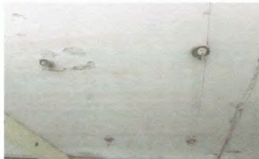
Foto 2: El sistema electrico en salon de usos multiples esta deteriorado es necesario hacer el cambio.
