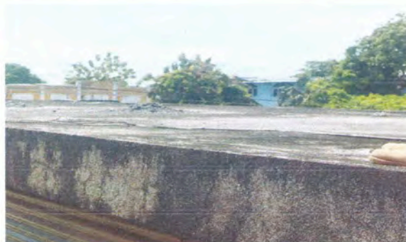
Foto 3: La terraza del salon de usos multiples presenta lugares donde el agua se filtra, con una reparacion en los pañuelos se solucionara.
