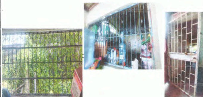
Foto 9: La balconeria en cocina esta ya muy detereorado es necesario mantenimiento.
