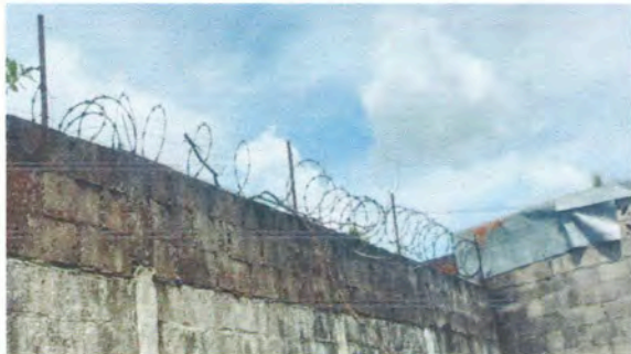
Foto 1: Es evidente el deterioro de las cuchillas de acero, ya no ofrecen protección y seguridad al muro colindante.
