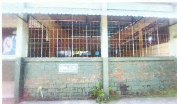
Foto 7: Para evitar que el agua de lluvia entre en el salon del modulo 2 es necesario colocar ventanas.
