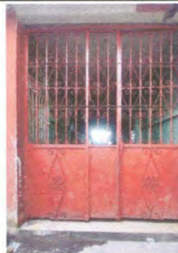
Foto8: Es evidente el detereoro del porton que esta en tre el modulo 2 y 3 y para evitar que los niños se lastimen se cambiara
