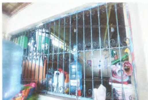
Foto 10: La ventana es utilizada por cocina y un salon de clases, para dar mejor seguridad se debera colocar una ventana
