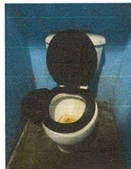
Foto 8: Se observa el mal estado del inodoro y su mal funcionamiento por lo que es necesario su cambio
