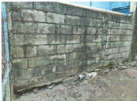
Foto 1: Se observa columnas expuestas y grietas a lo largo de todo el muro, por lo que es necesario sustitución
