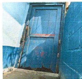
Foto 10: Se visualiza una puerta en mal estado y no tiene la capacidad de protección del aula, por lo que es necesaria sustituirla por una nueva.
