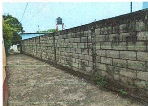
Foto 2: Se observa que la pared necesita protección por lo que es necesario un proceso de repello
