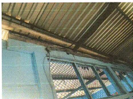
Foto 9: Se observa que el canal no tiene la capacidad de captación de agua por lo que se necesita sustituir por otro de mayor capacidad
