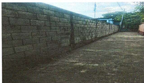
Foto 3: Se observa deterioro en la pared por lo que se necesita aplicar pintura.
