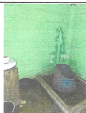
Foto 10: Se observa que el piso del baño requiere mantenimiento.
