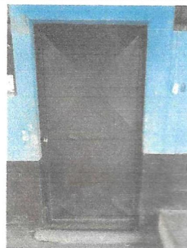
Foto 4: Se puede observar que las puertas requieren de mantimientto y pintura.
