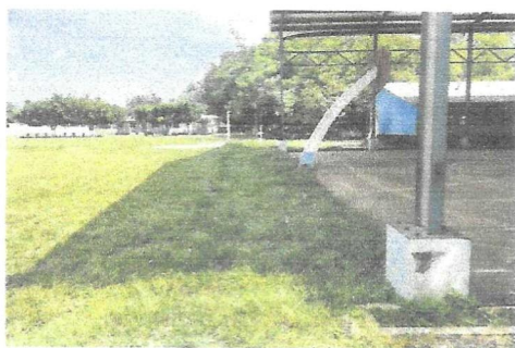
Foto 3: Se puede observar la necesidad de sumidero de drenaje pluvial
