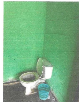
Foto 8: Se puede observar que los baños requieren sustitución, de igual forma solamente existe un baño, por lo que se requiere adecuar el lugar, para colocar 2 baños.
