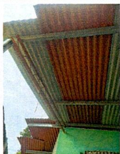
Foto 2.8: Se puede observar que la lámina esta deteriorada, por lo que requiere sustitución.
