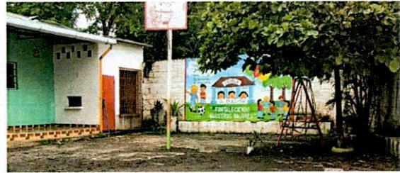
Foto 3.3: Se puede observar que el concreto del patio en su totalidad perimetral ya está bastante deteriorado, por lo que se suministrará una pequeña parte ya que es necesario por el riesgo que corren los estudiantes por su mal estado.
