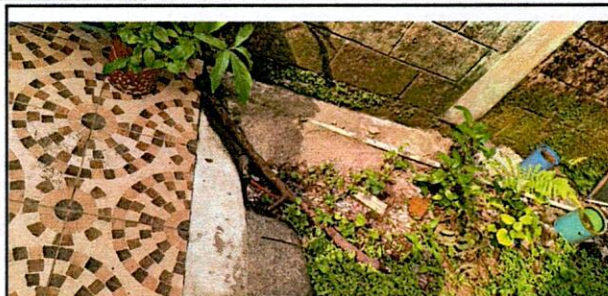
Foto 1.2: La tubería debe sustituirse ya que sufre deterioro por exposición al sol.
