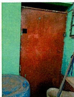
Foto 2.10: Se puede observar que la puerta colocada en la bodega es improvisada, por lo que se requiere su sustitución.
