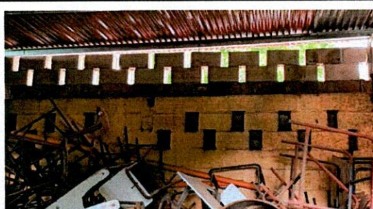
Foto 2.5: La pared se encuentra en mal estado por lo que se necesita sellar grietas y fisuras.
