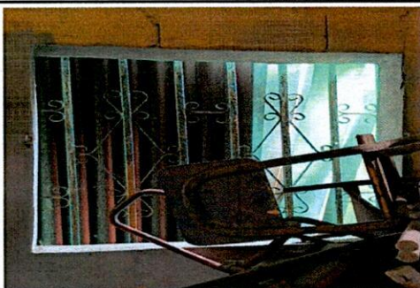
Foto 2.4: Se puede observar en el área que no existe ventana por lo tanto se suministrará ventana de PVC + vidrio.
