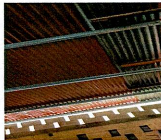
Foto 2.9: Se puede observar que el área no cuenta con energía eléctrica, por lo que se requiere suministrar sistema eléctrico.
