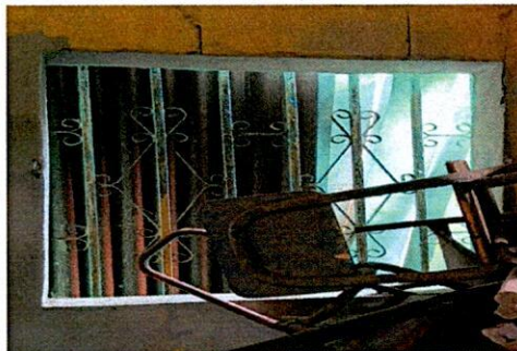
Foto 2.3: Se puede observar en el área, se necesita instalar nuevo balcón ya que el que existe se encuentra en mal estado.
