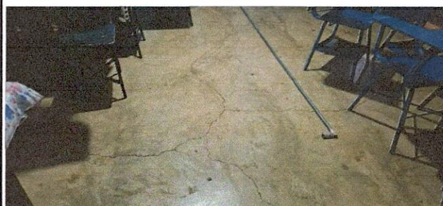
Foto 2: Se observa el estado actual del piso de las aulas que necesita la instalación de piso cerámico.
