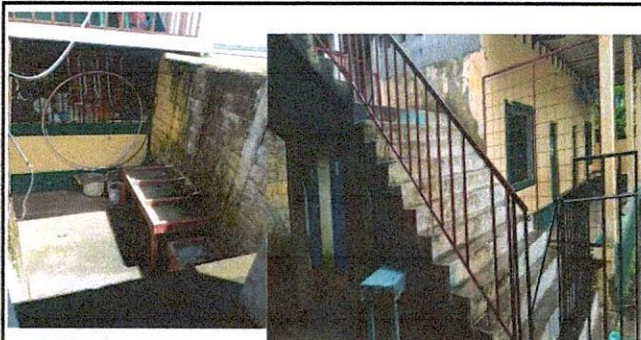
Foto 7: Se tiene la necesidad de suministrar lamina para cubrir los espacios por la lluvia y el sol, debido a que en epoca de lluvia los estudiantes se les dificulta movilizarse
