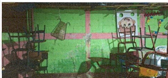
Foto 3: Se observa el estado actual de las paredes que necesitan aplicación de pintura.
