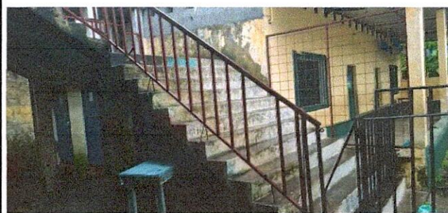
Foto 4: Barandas de metal que necesitan su correctivo mantenimiento.
