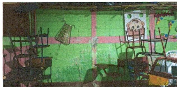
Foto 10: Se observa la necesidad de repellar la pared debido a la filtración de humedad.
