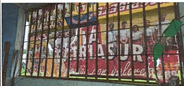
Foto 8: Balcón que necesita ser reemplazado por el deterioro que presenta
