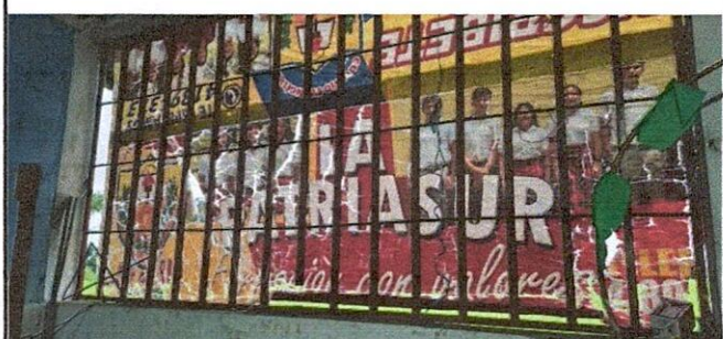
Foto 5: Estado actual de los balcones de las ventanas de las aulas que necesitan mantenimiento.
