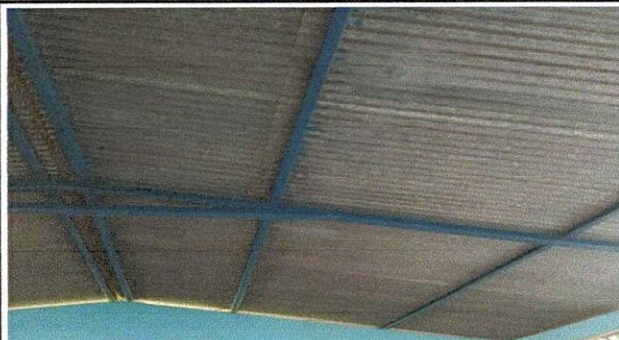
Foto 9: Se tiene la necesidad de suministrar cielo falso por motivo que se genera un calor muy fuerte y afecta la enseñanza.
