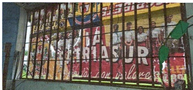
Foto 1: Se observa la necesidad de suministrar ventanas de PVC debido a la lluvia ingresa mucha brisa al aula.
