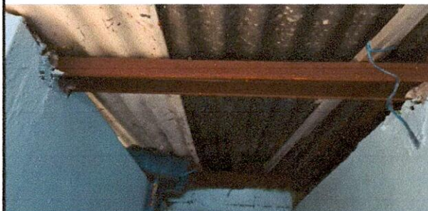
Foto 10: Se observa el deterioro en la estructura de soporte de metal del servicio sanitario, la cual deberá sustituirse.
