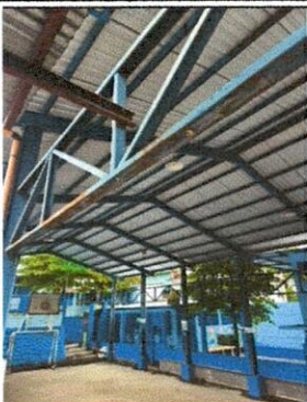
Foto 13: Se observa que la estructura de soporte de metal de la cancha presenta deterioro por lo que deberá recibir mantenimiento.
