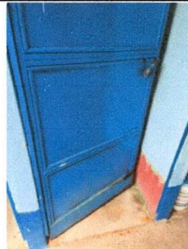
Foto 8: Se observa que la puerta exterior del servicio sanitario se encuentra dañada y no es funcional por lo que deberá ser sustituida.
