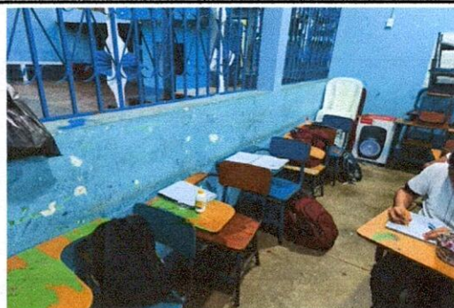
Foto 5: Se observa el deterioro y caída de la pintura interior de las aulas, por lo que deberá pintarse nuevamente.
