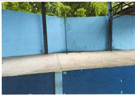
Foto 14: Se observa que el escenario no cuenta con piso cerámico, por lo cual deberá ser suministrado.
