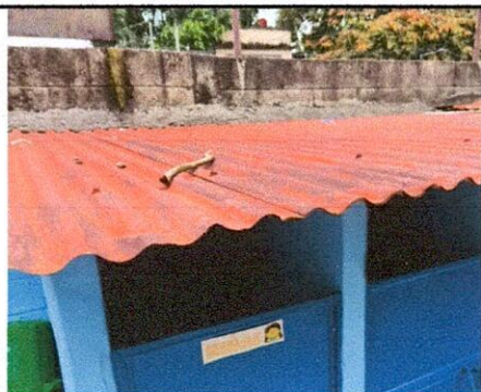
Foto 9: Se observa que las láminas del servicio sanitario se encuentran en mal estado, por lo que deberán sustituirse.
