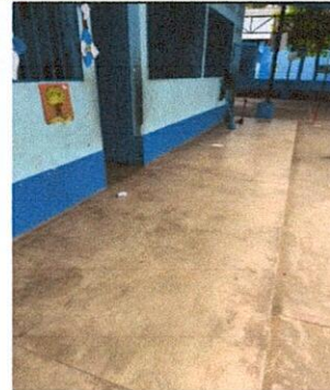
Foto 2: Se observa que el pasillo no cuenta con piso cerámico por lo que deberá suministrarse, este será antideslizante.
