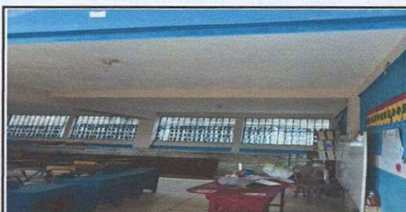
Foto 4: SE OBSERVA LA NECESIDAD DE MEJORAR EL ENPAÑUELADO DENTRO DE AULAS
