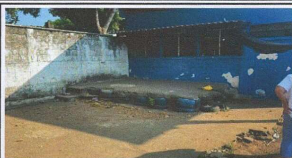
Foto 2: SE OBSERVA EL ESPACIO DEL ESCENARIO EN MAL ESTADO SE MEJORARA Y SE LE PONDRA PISO ANTIDESLIZANTE
