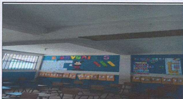
Foto 3: SE OBSERVA LA NECESIDAD EN EL ENPAÑUELADO DE LA TERRASA DENTRO DEL SALÓN DE CLASES
