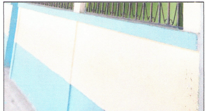
Foto 4: se observa que es necesario la aplicación de pintura en muros.
