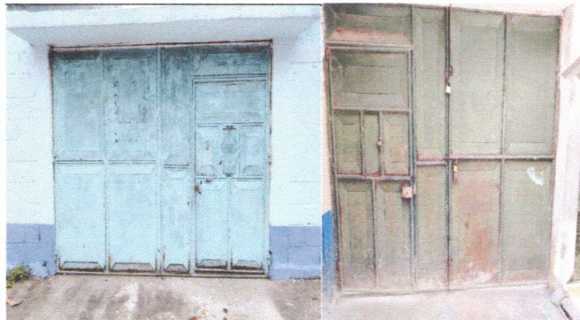
Foto 3: se observa que es necesario la sustitucion de porton de metal.
