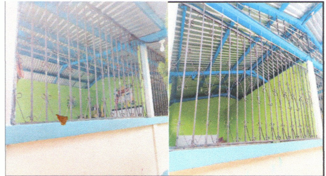
Foto 2: se observa que es necesario el suministro de ventana de pvc.
