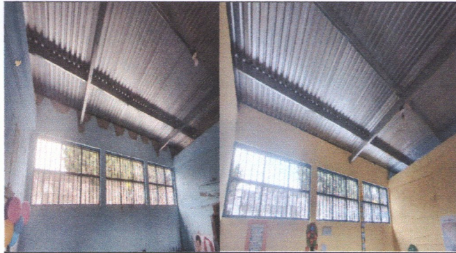
Foto 1: Se observa que es necesario el suministro de ventana de pvc.
