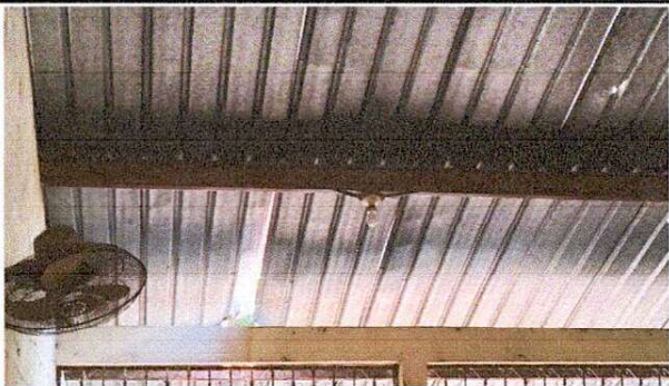
Foto 1: Se observa que la lámina se encuentra en mal estado y esto provoca la filtración de agua durante las lluvias.
