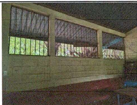
Foto 3: Se observa la falta de ventanas y se quiere prevenir la filtración de polvo exterior ya que se encuentran las computadoras
