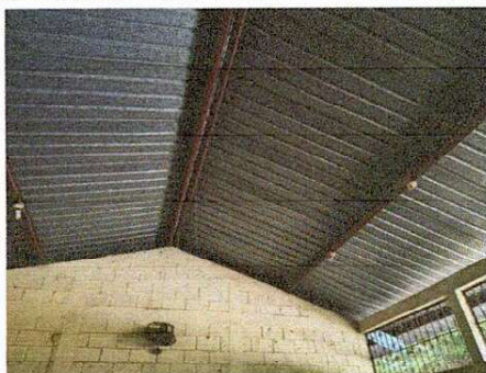
5. Se observa que las luminarias existentes ya no son funcionales
