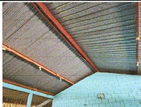
Foto 2: Se observa que las costaneras cuentan con corrosión
