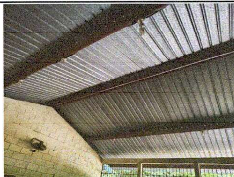
Foto 4: Se observa la falta de cielo falso por motivo que contamos con computadoras y así aislar el calor directo, producido por el techo hacia los estudiantes y equipo de cómputo
