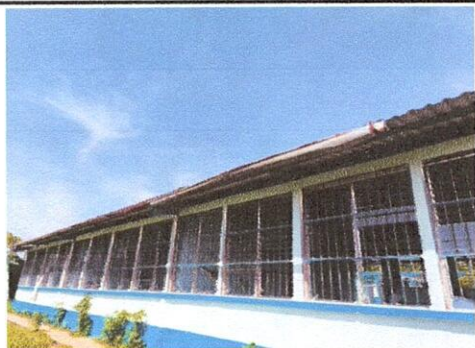
Foto 9: Se observa que los canales de metal no son funcionales por lo que deberán ser sustituidos.
