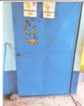
Foto 8: Se observa el inicio del deterioro en las puertas del módulo de aulas 3, por lo que se deberá brindar mantenimiento.
