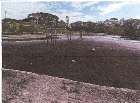
Foto 1: Se observa que se generan posas de agua sobre la losa del módulo de aulas 1, por lo que deberán repararse los pañuelos y repararse las salidas de agua.
