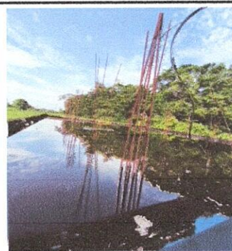
Foto 4: Se observa la acumulación de agua sobre la losa del módulo de aulas 2, por lo que se deberá reparar los pañuelos.
