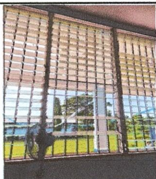
Foto 3: Se observan piezas de vidrio faltantes en la ventana por lo que deberán ser sustituidas.
