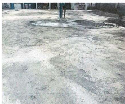
Foto 3: Se observa la falta de piso cerámico.
