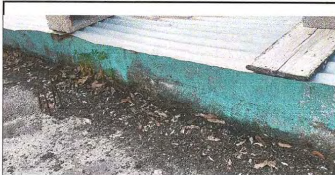
Foto 13: Se observa la necesidad de impermeabilizar la losa para evitar la filtración de agua hacia el aula.
