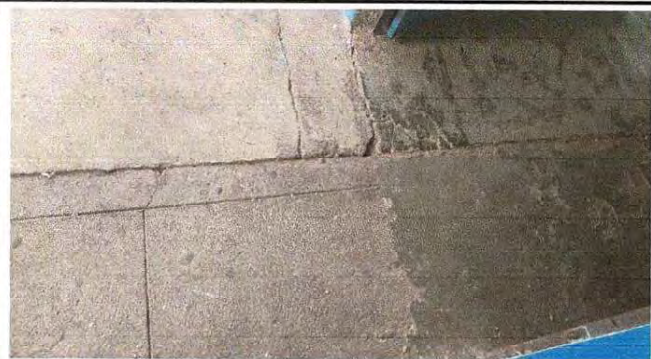
Foto 7: Se observa lo deteriorado que se encuentra el piso del aula y se ve la necesidad del suministro de piso cerámico en el aula
