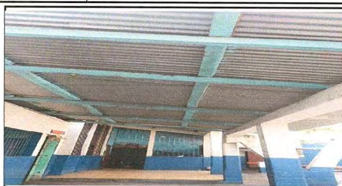
Foto 2: Se observa que la necesidad de cambio de estructura de madera por estructura de metal en el aula 1
