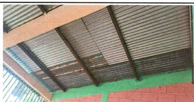
Foto 12: Se observa el mal estado de la lámina en el aula 2
