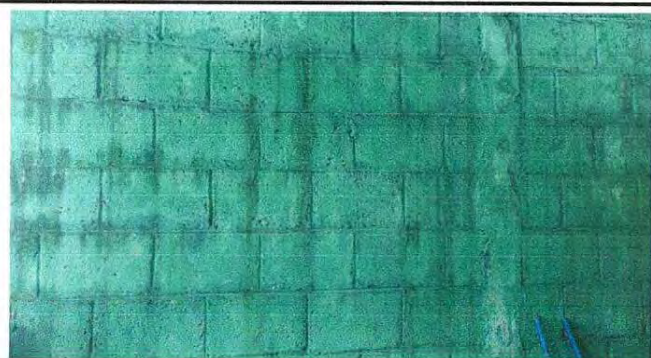
Foto 9: Se observa que las paredes del aula no cuentan con repello.
