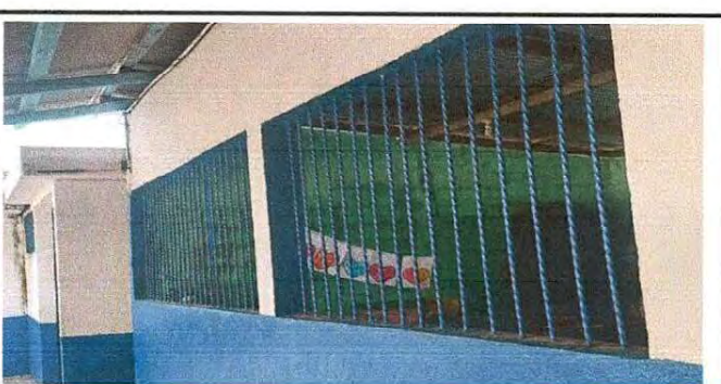
Foto 6: Se observa el aula cuenta con barrotes, los cuales impiden la correcta instalación de las ventanas, por lo que se debe mover y sustituir por balcones de de metal.
