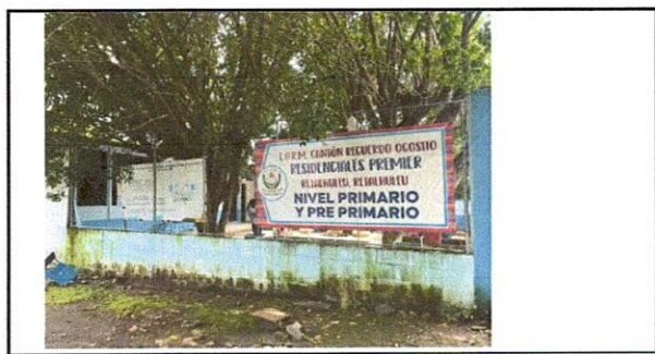
Foto 6: se observa la necesidad de sustituir el muro perimetral de block
