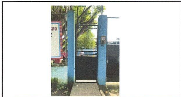
Foto 2: Se observa la necesidad dar mantenimiento a puerta de metal de aula
