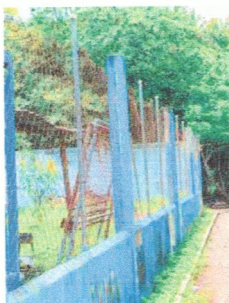
Foto 3: Se observa la cerca perimetral que se sustituirá.
