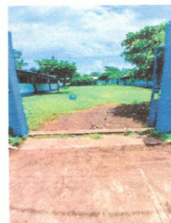
Foto 3: Se observa la plancha de concreto que se sustituirá.
