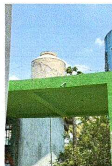
Foto 2: Se observa el deposito de agua al cual se le deben cambiar los accesorios.
