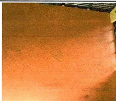
Foto 5: Se observa el área de la pared que debe resanarse.
