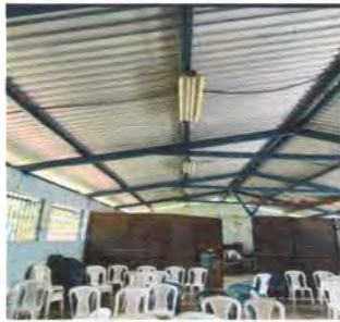
Foto 3: Se observa el area a la que se le sustituirá el sistema electrico.
