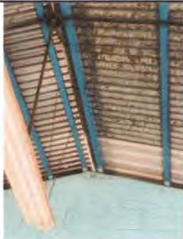
Foto 1: Se observa la lamina que se sustituirá.
