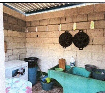
Foto 6: Es necesario mejorar el aspecto de las paredes de la cocina.
