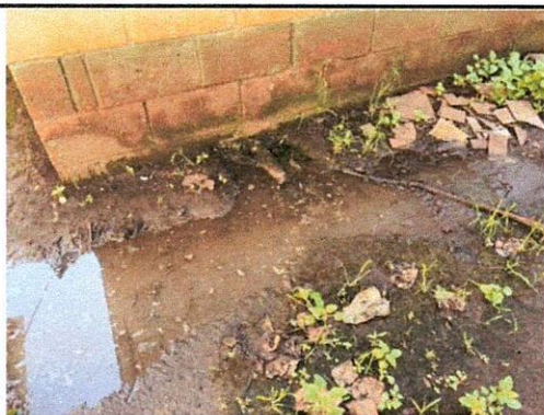
Foto 9: Es necesario instalar drenaje en la cocina.
