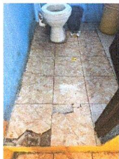
Foto 1: SE OBSERVA LA NECESIDAD DE SUSTITUIR EL PISO CERÁMICO Y EL AZULEJO EN LOS BAÑOS.
