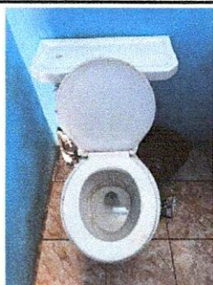
Foto 3: SE OBSERVA LOS INODOROS EN MAL ESTADO, URGE SUSTITUIRLOS.
