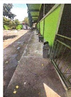
Foto 2: ES NECESARIO INSTALAR PISO CERÁMICO EN EL CORREDOR.
