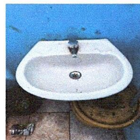
Foto 4: LOS LAVAMANOS ESTÁN DAÑADOS, ES NECESARIO SUSTITUIRLOS.
