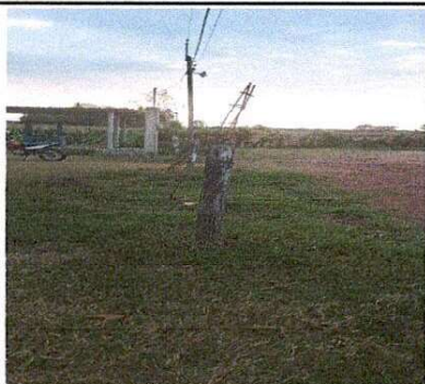
Foto 3: SE OBSERVA QUE UNICAMENTE SE CUENTA CON LOS POSTES DE CONCRETO, QUE EN ALGUN MOMENTO SIRVIERON COMO CERCA PERIMETRAL, POR LO QUE URGE SU SUSTITUCION POR UN MURO PRE FABRICADO.
