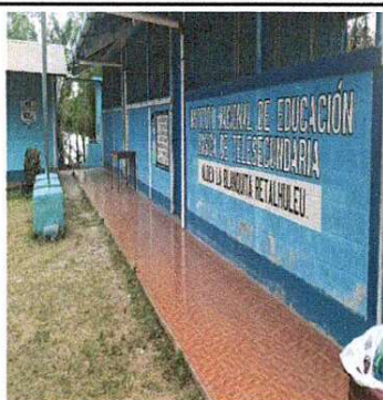
Foto 1: SE OBSERVA QUE LA PINTURA EXTERIOR E INTERIOR ESTA EN MAL ESTADO, POR LO QUE URGE QUE SE LE APLIQUE PINTURA.
