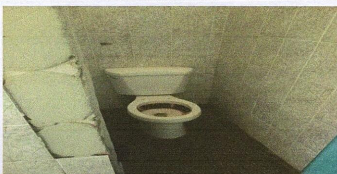
Foto 6: Se observa los sanitarios de los docentes en mal estado, urge sustituirlos
