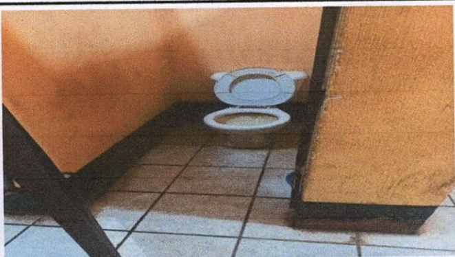
Foto 2: Se observa los inodoros de las señoritas en mal estado, urge sustituirlos
