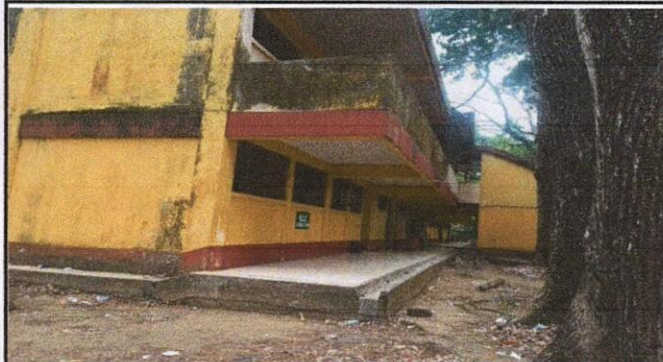
Foto 5: aplicar pintura porque ya se necesita, ya se mira con mucho moho
