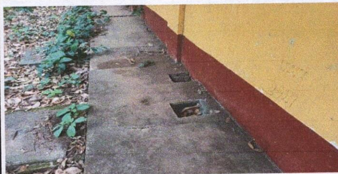
Foto 2.1: sustitución de tubería de agua potable, urge porque no pasa agua potable para baños de señoritas
