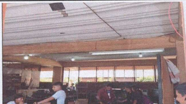
Foto 2: Por el tiempo varias láminas tienen goteras las cuales ya están dañadas.
