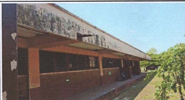
Foto 1: Fachada del aula, se necesita el cambio de lamina duralita por lámina troquelada.
