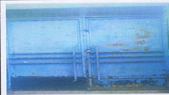
Foto 10: Se observa el deterioro del portón principal del salón de usos múltiples, es necesario aplicar mantenimiento preventivo y correctivo
