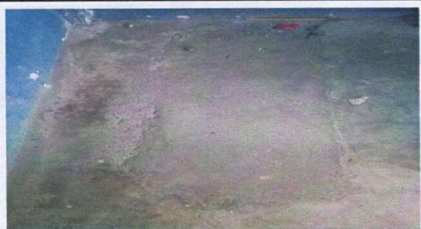
Foto 7: Se observa el piso de los sanitarios en deterioro, es necesario colocar piso cerámico para una mejor higiene
