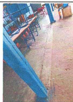
Foto 2: Se observa que hace falta una cuneta para evitar la inundación por las lluvias
