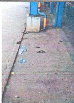
Foto 3: Se observa en mal estado el caminamiento
