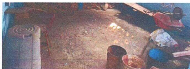
Foto 6: Se observa que el piso de la cocina no cuenta con piso y por lo tanto no reúne las condiciones necesarias para cocinar
