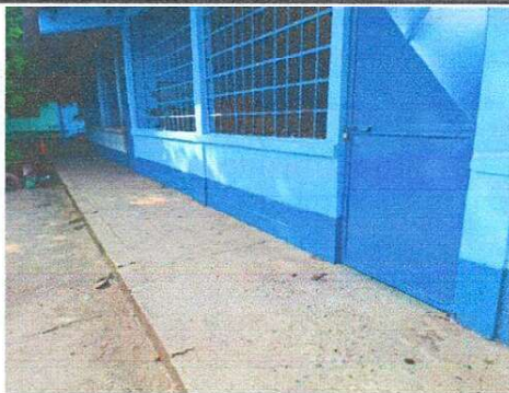
Foto 9: Se observa que el pasillo del módulo 1 no cuenta con piso formal y en invierno es un inconveniente para los niños
