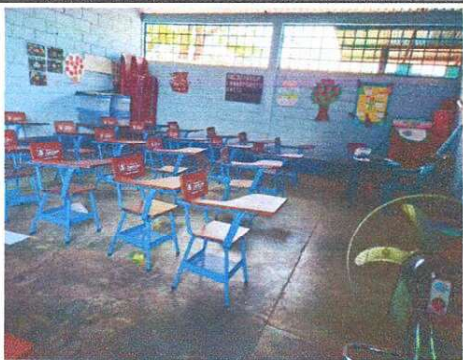
Foto 7: Se observa que el piso del Aula No. 2 se encuentra en mal estado
