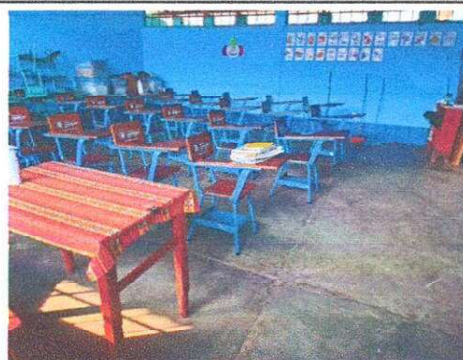
Foto 8: Se observa que el piso del Aula No. 3 se encuentra en mal estado
