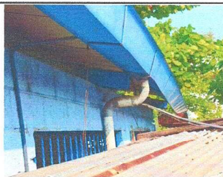
Foto 4: Se sobserva el mal estado del canal y no cumple con su función
