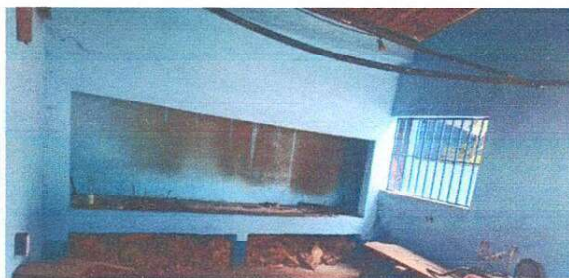
Foto 5: Se observa que las paredes de la cocina no cuenta con azulejo, esto se evita el moho y telarañas
