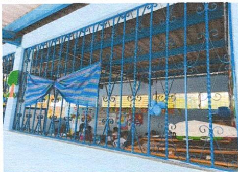
Foto 9: Se observa que los balcones se comienzan a oxidar en algunas áreas por lo que deberán recibir mantenimiento.
