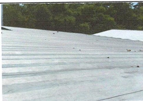
Foto 5: Se observa que deberá brindarse mantenimiento a las láminas debido a su antigüedad.
