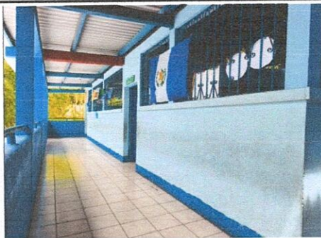
Foto 11: Se observa el deterioro en la pintura en el segundo nivel del módulo 2 por lo que se deberá aplicar pintura.
