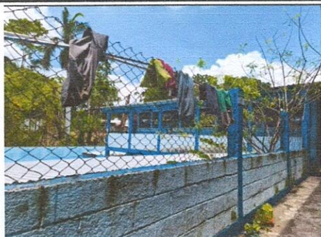
Foto 15: Se observa daños y deterioros en la malla del muro divisorio por lo que esta deberá ser sustituida por balconería.
