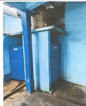
Foto 14: Se observa el desgaste de la pintura en el área de servicios sanitarios, por lo que deberá aplicarse nueva pintura.
