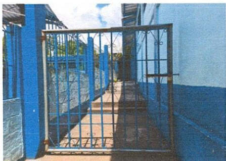
Foto 17: Se observa el deterioro del portón por lo que este deberá recibir mantenimiento.
