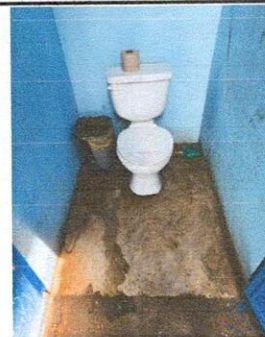
Foto 12: Se observa que el área de servicios sanitarios no cuenta con piso cerámico por lo que este deberá ser suministrado.
