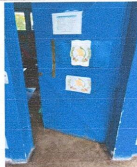
Foto 2: Se observa el inicio del deterioro y oxidación de las puertas del módulo 1, por lo que se les deberá brindar mantenimiento.
