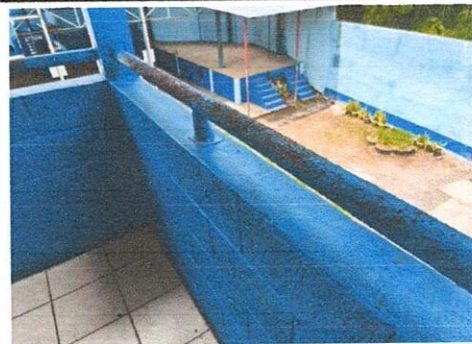
Foto 10: Se observan las barandas de metal en mal estado y con óxido, por lo que deberán ser sustituidas.
