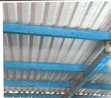
Foto 6: Se observa que la estructura de soporte de metal del módulo 2 comienza a dañarse y oxidarse, por lo que deberá recibir mantenimiento.
