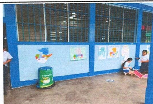
Foto 3: Se observa el desgaste de la pintura del módulo 1 por lo que este deberá de ser pintado.
