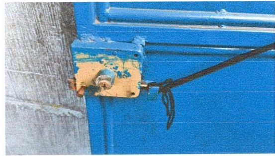
Foto 8: Se observa que la chapa de la puerta no es funcional, por lo que deberá ser sustituida.
