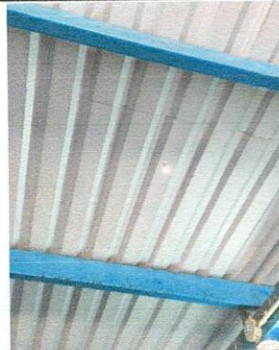
Foto 4: Se observa que algunas láminas del módulo 2 se encuentran agujereadas, por lo que deberán ser sustituidas.
