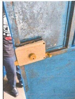
Foto 16: Se observa que la chapa no es funcional por lo que esta deberá ser sustituida.
