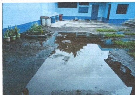
Foto 18: Se observa que el área de patio no cuenta con plancha de concreto, lo que provoca el empozamiento de agua, la plancha de concreto deberá ser suministrada.
