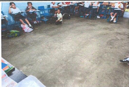
Foto 1: Se observa que el módulo 1 no cuenta con piso cerámico por lo que deberá ser suministrado.
