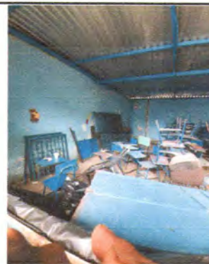
Foto 2: Se observa el aula muy deteriorada por lo que se dara mantenimiento.
