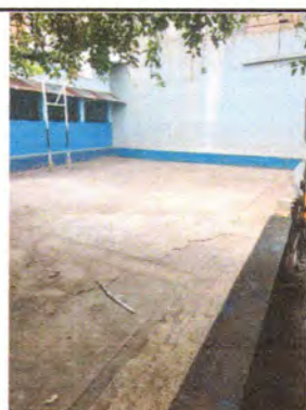
Foto 3: Se observa en mal estado la cancha, es necesario sustituirla.
