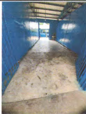
Foto 1: Se observa el piso del salon es de concreto, siendo necesario suministrar piso ceramico.
