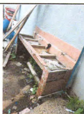
Foto 4: Se observa en mal estado los chorros y lavamanos, es necesario sustituirlos.
