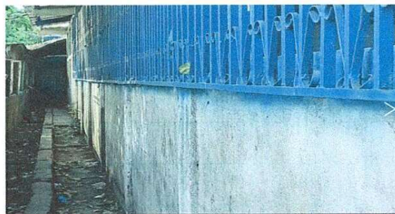
Foto 2: SE OBSERVA QUE LA PARED ESTA EN MAL ESTADO POR LO QUE URGE LA APLICACIÓN DE PINTURA PARA PROTEGER LA PARED.
