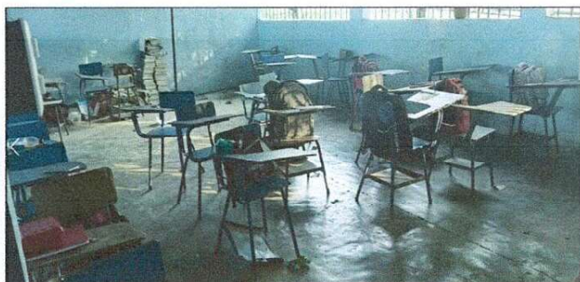
Foto 3: SE OBSERVA QUE EL PISO DE CEMENTO ESTA RAJADO , POR LO QUE URGE LA SUSTITUCION POR PISO CERAMICO.
