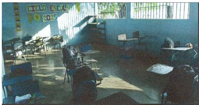
Foto 1: SE OBSERVA QUE EL PISO DE CEMENTO ESTA RAJADO , POR LO QUE URGE LA INSTALACIÓN DE PISO CERAMICO.
