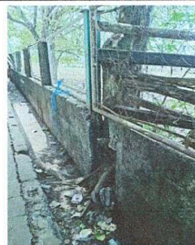
Foto 4: SE OBSERVA QUE LA CERCA PERIMETRAL SE ENCUENTRA EN MAL ESTADO, ES NECESARIA SU SUSTITUCION.
