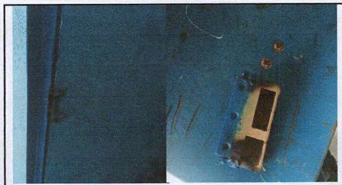
Foto 12: se odserva chapa inservible y necesita cambio
