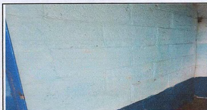
Foto 11: se observa la necesidad de aplicación de pintura latex acrílica en servicio sanitario
