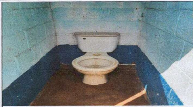
Foto 8: Se observa los inodoros en mal estado y necesita sustitución
