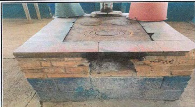
Foto 13: Se observa que la estufa necesita reparación.
