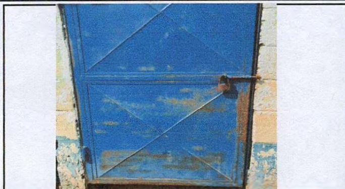
Foto 7: Se observa que la puerta, se encuentra en mal estado y necesita mantenimiento.
