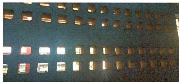
Foto 10: Se observa pared con poca iluminación y ventilación. Se necesita la conformación del área de ventana para iluminar y ventilar el salón de clases.
