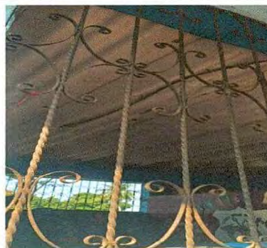
Foto 2: Se observa balcón en mal estado. necesita mantenimiento preventivo y correctivo.
