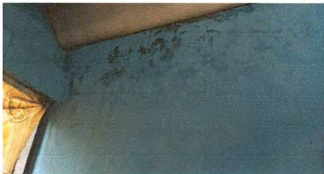
Foto 13: Se observa deterioro y mal estado de pintura por humedad. Se necesita aplicación de pintura nueva.
