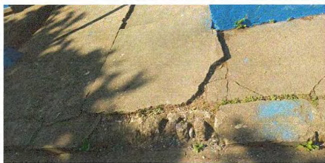
Foto 14: Se observa banqueta quebrada y dañada por antigüedad. Urge sustitución.
