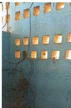
Foto 9: Se observa pared donde se necesita conformación de puerta para acceso de los niños y niñas, así como ventilación.
