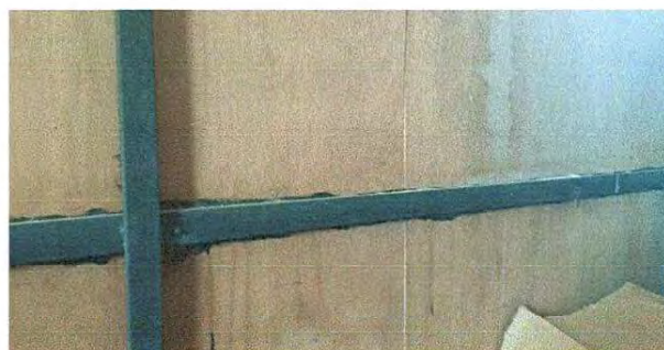
Foto 4: Se observa entrepaño de plywood en mal estado y dañado por la polilla. Se necesita sustitución.
