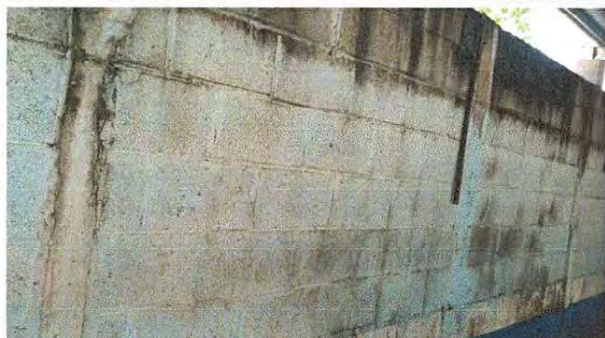
Foto 15: Se observa deterioro de pintura en muro perimetral, se necesita aplicación de pintura nueva.
