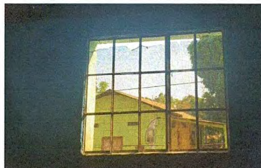
Foto 8: Se observa ventana de malla y metal bastante antigua y en mal estado. Se Necesita sustitución.
