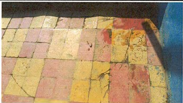
Foto 7: Se observa piso dañado y en mal estado. Urge cambiarlo.
