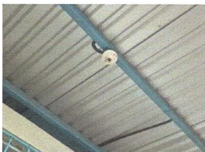
Foto 9: Se observan sistema eléctrico sin funcionar y falta de focos
