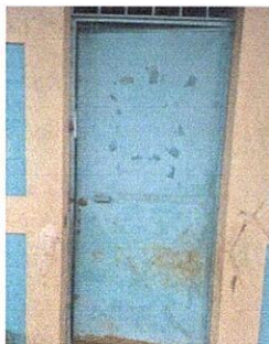
Foto 7: Se observan puertas con falta de mantenimiento
