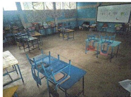
Foto 8: Se observan aulas sin piso cerámico
