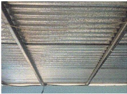
Foto 3: Se observa lámina mal instalada y doblada que permite filtración
