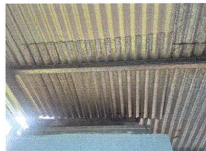
Foto 4: Se observan secciones de metal cortos y estructura pequeña en general que permite filtración
