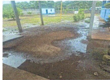
Foto 2: Se observa area común sin plancha de concreto
