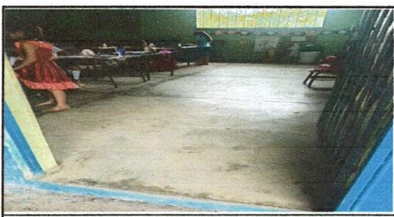
Foto 6: se observa la necesidad de instalación de piso cerámico.
