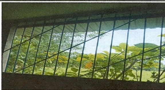
Foto 7: Se observa la necesidad de sustitución de balcón.
