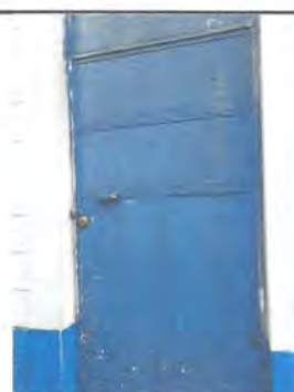
Foto 6: Sustitución de chapa. La chapa no sirve
