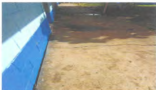
Foto 1: Sumistro e instalación de piso cerámico anti deslizante. Se observa en mal estado y rustico.
