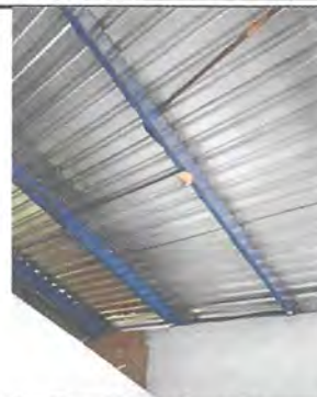
Foto 2: Sustitución del Sistema Eléctrico, no hay energía eléctrica en los focos de la dirección, aula de parvulos y aulas de 5to y 6to.
