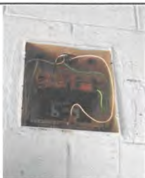
Foto 3: Sustitución del Sistema Eléctrico, no hay energía eléctrica
