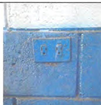
Foto 4: No hay energía eléctrica en los tomacorrientes
