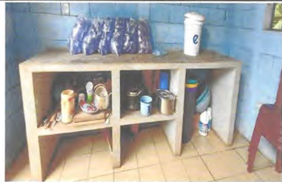
Foto 8: Suministro de instalación de Azulejo. Podemos observar que se encuentra muy rústico.
