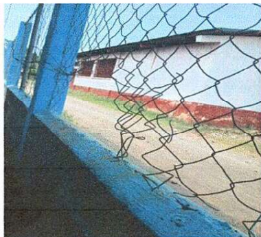
Foto 7: Se observa malla de muro perimetral en mal estado.
