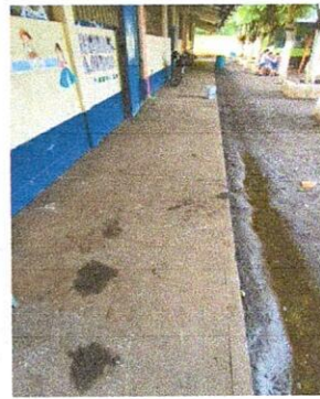
Foto 2: Se observa que en el área del corredor no se cuenta con piso antideslizante.
