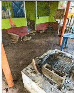
Foto 7: Se observa que el área de cocina cuenta con piso de tierra por lo que deberá suministrarse una base granular para poder instalar piso cerámico.
