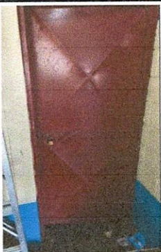
Foto 3: Se observa el inicio del deterioro de las puertas del módulo 1 por lo que deberá brindarse mantenimiento.
