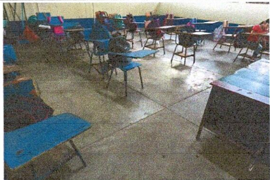
Foto 1: Se observa que en el interior de las aulas no se cuenta con piso cerámico.
