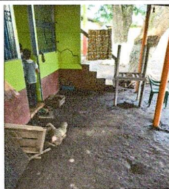
Foto 8: Se observa que en el área de cocina no se cuenta con piso cerámico el cual deberá ser colocado posterior a la colocación de la base granular.
