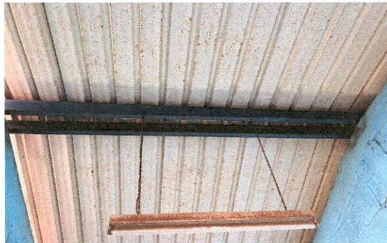
Foto 2: Se observa que la estructura requiere mantenimiento.
