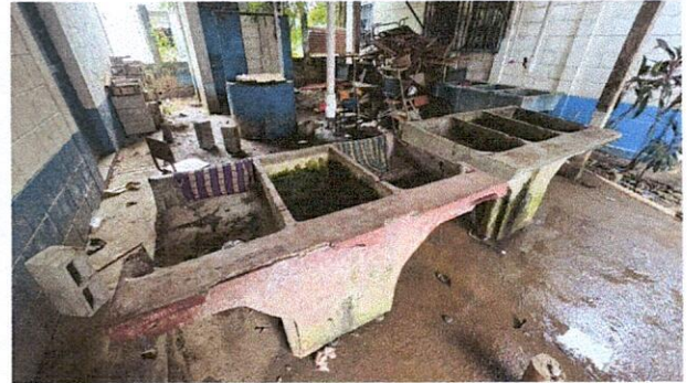
Foto 8: Se observa que las pilas se encuentran dañadas.
