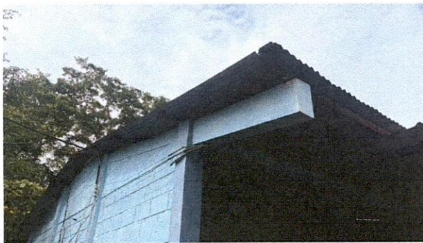
Foto 9: Se observa que la lámina se encuentra dañada.
