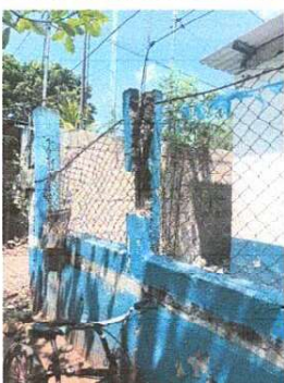
Foto 3: Se observa que el muro perimetral necesita pintura para darle una mejor apariencia al establecimiento
