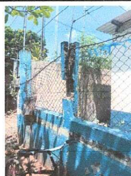
Foto 2: Se observa que al momento de que el muro se sustituya necesitara repello para una mejor presentación
