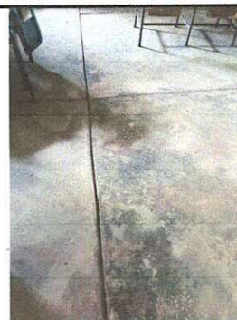
Foto 4: Se observa que el aula no cuenta con piso cerámico
