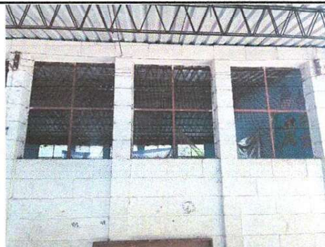
Foto 8: Se observa que el aula no cuenta con balcones adecuados, y se encuentran en mal estado
