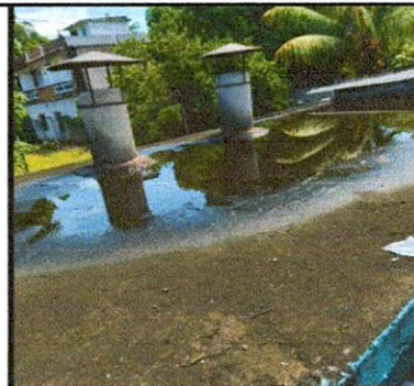
Foto 14: Se observa que la losa no cuenta con impermeabilizante.
