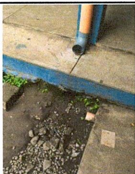
Foto 9: Se observa que no se cuenta con cajas de registro para el agua pluvial.
