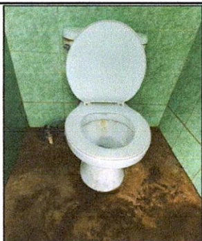
Foto 1: Se observa que los inodoros del servicio sanitario presentan fugas de agua.
