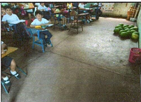
Foto 15: Se observa que las aulas no cuentan con piso cerámico.
