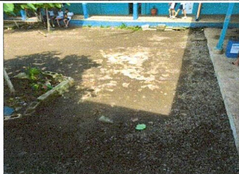
Foto 8: Se observa que no se cuenta con una placha de concreto por lo que se acumula lodo.
