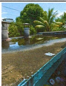
Foto 13: Se observa la acumulación de agua en la losa por lo que deberán repararse los pañuelos.
