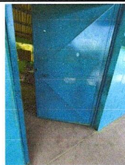
Foto 16: Se observa el inicio en el deterioro de las puertas del módulo 3.
