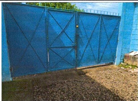
Foto 7: Se observa el deterioro del portón por lo que se deberá brindar mantenimiento.
