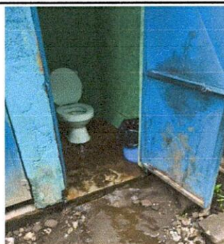
Foto 2: Se observa que los baños presentan taponamientos constantes debido a que el sistema de drenaje es inapropiado por lo que deberá ser sustituido.
