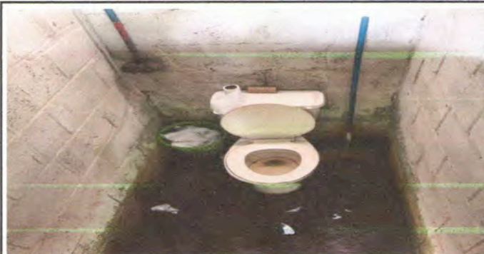
Foto 10: Se observa la necesidad de piso ceramico
