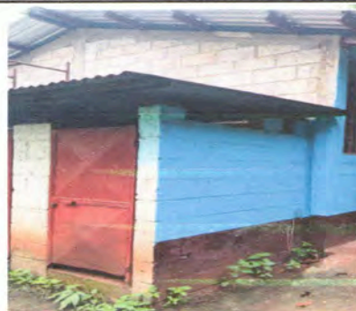
Foto 8: Se observa la necesidad de cambio de lamina de techo
