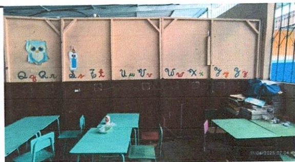
Foto 5: Es necesario sustituir la división de madera por tabla yeso.
