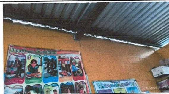
Foto 6: Es necesario sanar las fisuras en las paredes y no entre la humedad.
