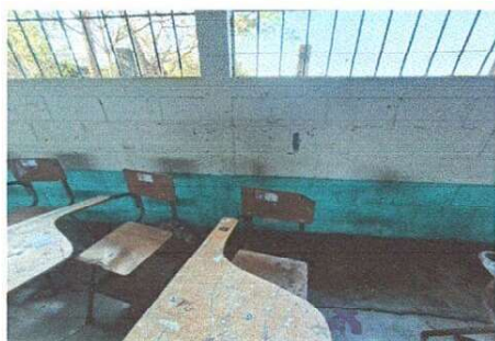
Foto 3: Se observa que las paredes ya están sucias y deterioradas, es necesario aplicarles pintura.
