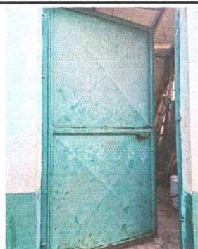
Foto 5: Se observa que la puerta ya se está deteriorando, necesitan mantenimiento.
