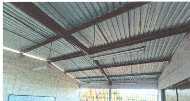
Foto 2: Se observa que las unidades del sistema eléctrico ya no son funcionales, por lo que deben ser sustituidos.
