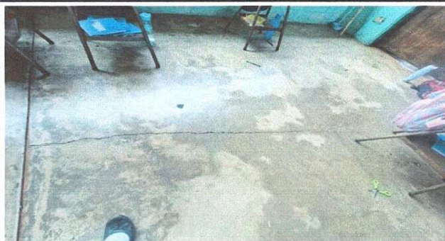
Foto 1: Se observa que se cuenta con piso de cemento en mal estado, por lo que se debe suministrar piso de concreto.
