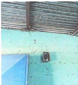
Foto 7: Se observa que el sistema electrico de la cocina no es funcional, se debera sustituir.
