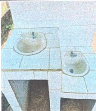
Foto 3: El uso ha afecta la llaves de los lavamanos y asi ya no cumplen su función es necesario repararlos.
