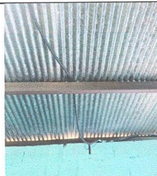
Foto 10: Se observa el daño que tienen las costaneras, por lo que deben ser sustituidas.
