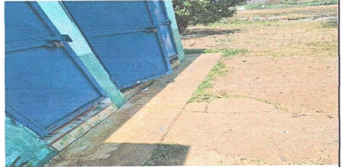
Foto 2: Se observa que las puerta de ingreso a los sanitarios se ven oxidadas debido al uso y paso de los años. Requieren mantenimiento.
