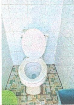
Foto 1: Se observa el deterioro de los sanitarios, a parte el funcionamiento ya no es satisfactorio
