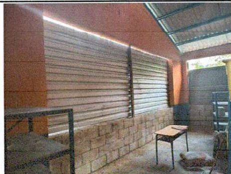
Foto 4: Se observa la falta de ventanas en el aula, para que el aire circule
