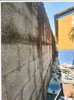
Foto 9: Se observa que el muro perimetral se encuentra en mal estado ya que no cuenta con repello.
