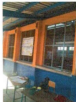
Foto 8: Se observa que la malla de las ventanas se encuentra en mal estado de lado a lado, Es necesario suministrar balcones de metal.
