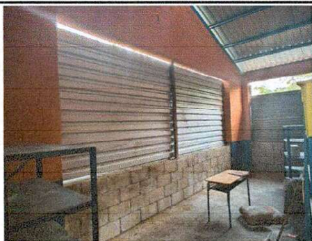
Foto 1: Se observa que el muro del aula necesita reparación, para brindar seguridad a los estudiantes
