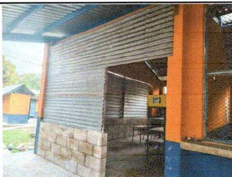
Foto 3: Se observa la falta de una puerta en el aula
