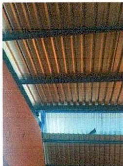
Foto 7: Se observa que en el aula no hay sistema eléctrico
