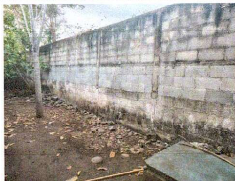
Foto 10: Se observa que el muro perimetral necesita pintura
