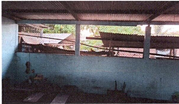
Foto 7: Se observa que los balcones son de malla, por lo que se deberán sustituir por balcones de metal.
