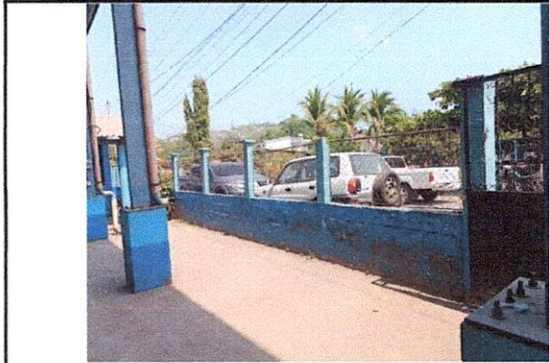
Foto 1: Se observa la cerva perimetral dañada, podría caer. Es necesaria su sustitución.
