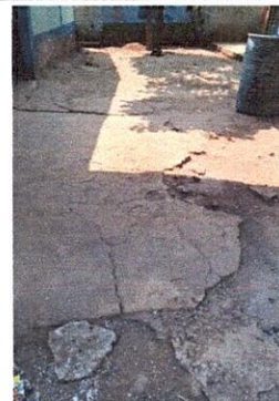
Foto 4: Se observa que las planchas de concreto de patio necesitan ser reparadas.
