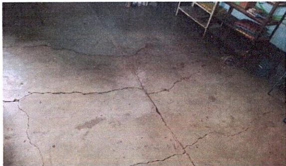
Foto 9: Se observa que el piso en el aulas es de concreto, debiera ser suministrado piso ceramico.
