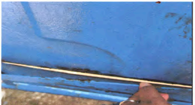
Foto 22: Por las lluvias y el tiempo del portón principal de la escuela se ha deteriorado por lo que se solicita su mantenimiento.
