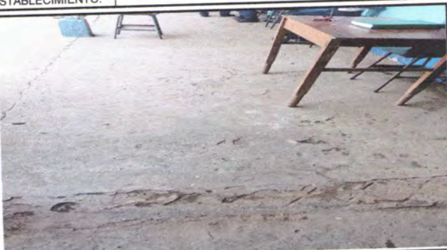
Foto 7: Los corredores son de cemento rustico por lo que los niños se raspan constantemnte por lo que se necesita de suministro e instalación de piso cerámico antideslizante.
