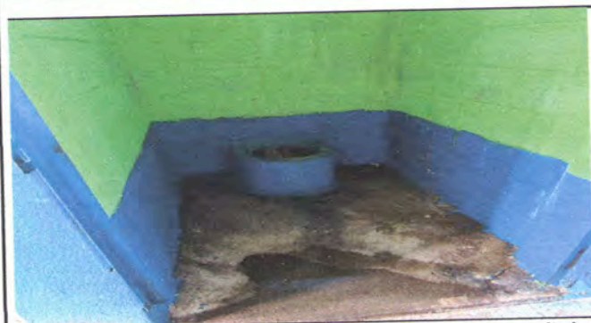
Foto 17: Se solicita el suministro de piso cerámico en servicios sanitarios para mejorar la higiene de los mismos.
