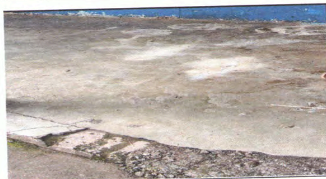
Foto 18: En el módulo 3 de aulas los corredores están manchados y en parte deteriorados por lo que se solicita el suministro e instalación de piso cerámico antideslizante.
