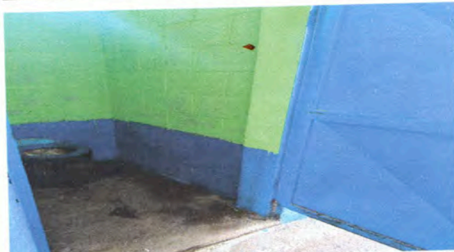
Foto 16: Para mejor presentación de sanitarios se solicita el suministro e instalación de azulejo.
