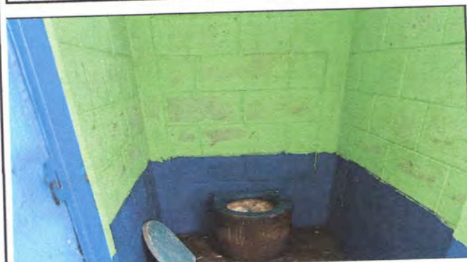
Foto 9: Los sanitarios son de tipo letrina por lo que se solicita la sustitución a sanitarios lavables.
