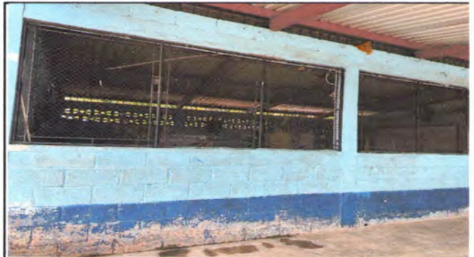
Foto 20: Para seguridad y resguardo de mobiliario y pertenencias de aulas se solicita la sustitución de balcones de malla por balcones de metal.
