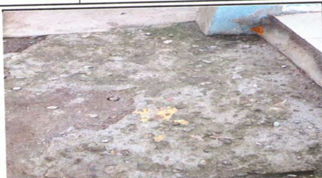
Foto 14: Por el agua y con el paso del tiempo la banqueta de concreto de los servicios sanitarios en una parte se encuentra deteriorada por lo que se solicita la sustitución de la misma,
