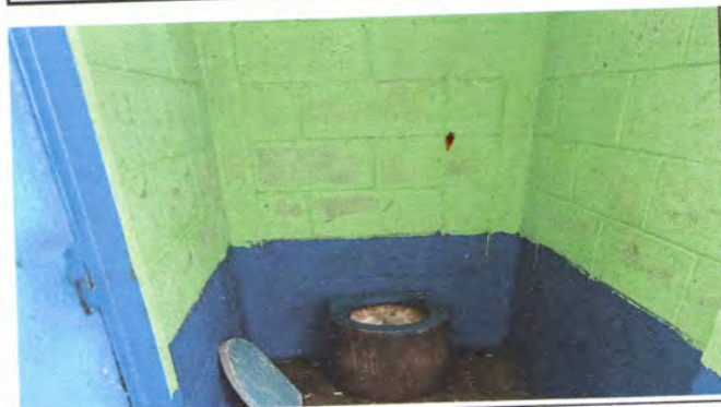
Foto 10: Los muros de los baños necesitan de ser repellados para tener una mejor presentación.
