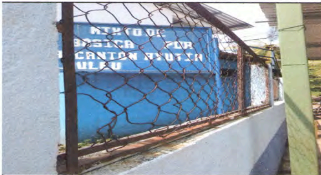
Foto 21: Debido al tiempo y a las personas que han querido perjudicar la mayoría de malla del muro perimetral se encuentra con hoyos y óxido por lo que se solicita la sustitución de la cerca perimetral.
