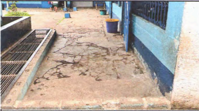
Foto 1: Por el pasp del tiempo la banqueta de corredor se encuentra deteriorada por lo que se solicita el resane del área por medio de reparación de banqueta de concreto.
