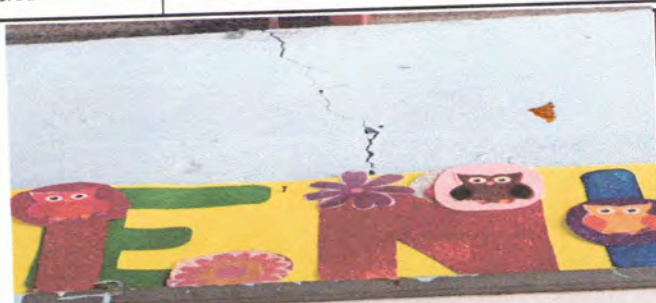
Foto 8: Hay gietas en uno de los muros de este módulo que necesitan ser selladas para evitaar males mayores.
