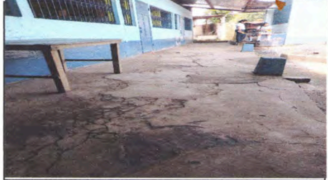
Foto 2: Por deterioro del área se necesita de suministro e instalación de piso cerámico antideslizante.
