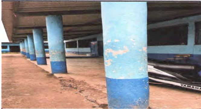
Foto 19: En muros y columnas exteriores del módulo 3 luces despintadas y sucias por lo que se solicita la aplicación de pintura para su mantenimiento,
