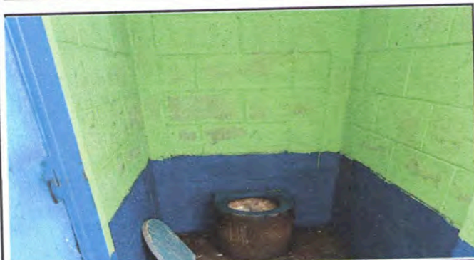
Foto 15: Los muros de los sanitario serán repellados por lo que se solicita el alisado de los mismos.
