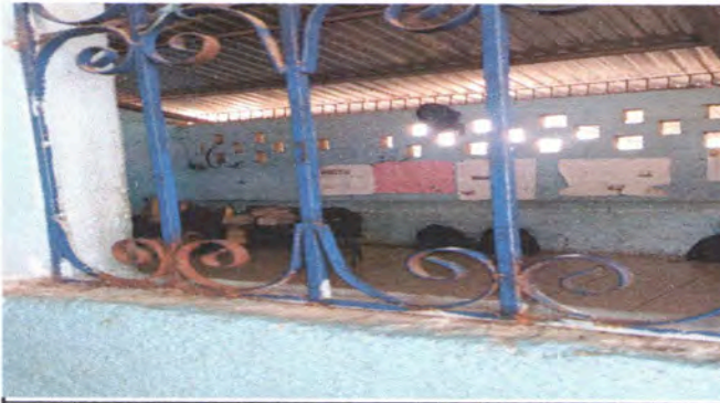
Foto 3: Los balcones lucen oxidados por lo que se solicita el mantenimiento correspondiente.
