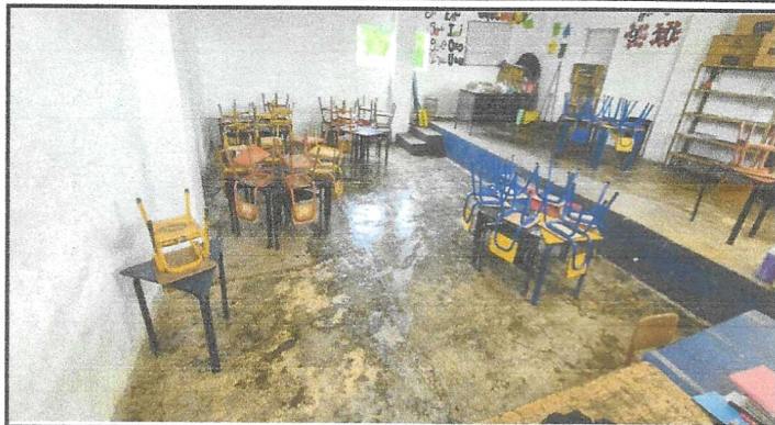
Foto 1: Se observa la necesidad de mejorar el piso existente
