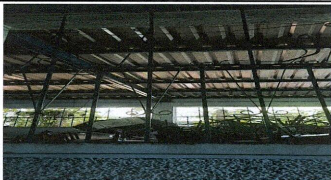
Foto 3: Los balcones actuales son de mala calidad y están en deterioro urge el cambio.
