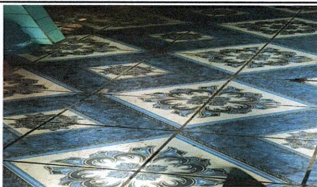
Foto 8: se necesita el cambio de piso.
