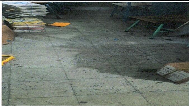
Foto 1: Se observa el piso de concreto, necesario suministrar piso cerámico.
