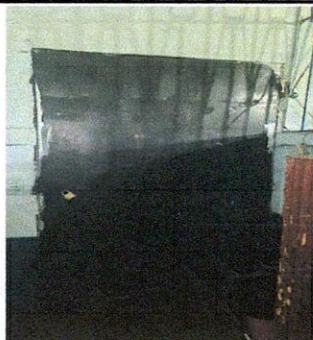
Foto 5: urge la sustitución de puerta de la dirección con chapa por motivo de que la actual está deteriorada.
