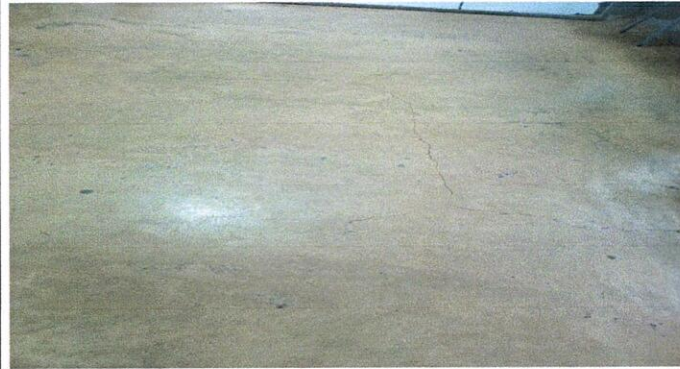
Foto 1: Piso del aula, se necesita cambio por piso cerámico.
