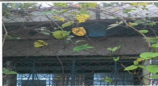
Foto 9: Cubierta de lámina por motivo que quedó muy corta la lámina y se entra el agua al aula.
