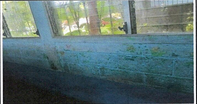
Foto 10: Repello de muro por humedad.
