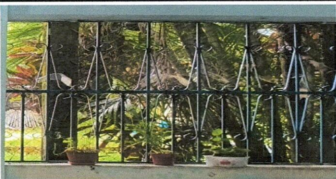
Foto 17: La ventana se encuentra en mal estado urge la sustitución
