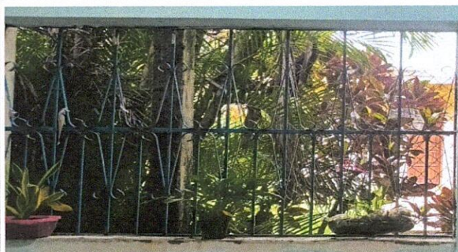
Foto 16: La ventana se encuentra en mal estado urge la sustitución.
