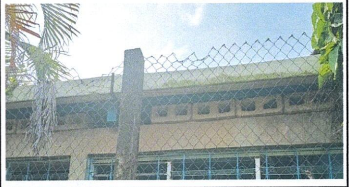
Foto 2: La lámina quedó corta, se necesita agregar lámina para que no se entre el agua al aula.
