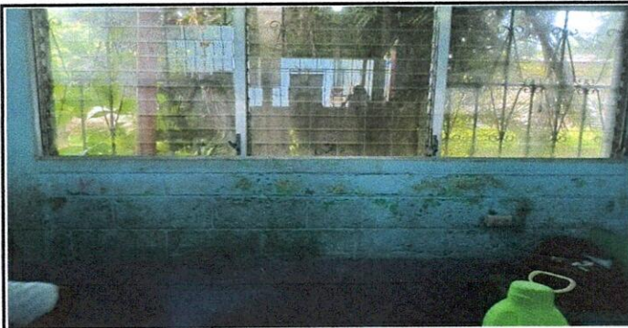
Foto 5: Sellado de grietas y fisuras urge por humedad
