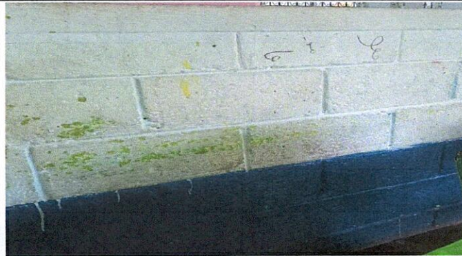
Foto 7: Urgencia la pintura del aula.
