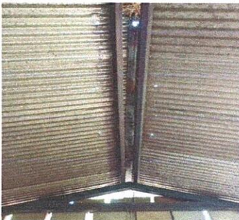
Foto 3: Se necesita sustituir estructura en malas condiciones
