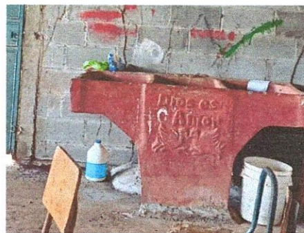
Foto 14: Es necesario sustituir pila en malas condiciones
