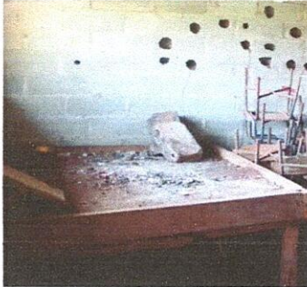
Foto 1: Se necesita sustituir polleton por estufa rural
