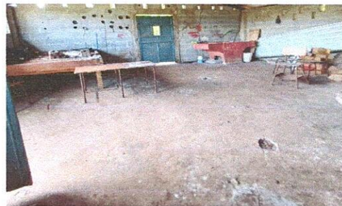
Foto 6: Es necesario instalar piso cerámico
