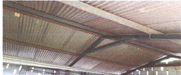
Foto 2: Se necesita sustituir laminas en mal estado por láminas troqueladas
