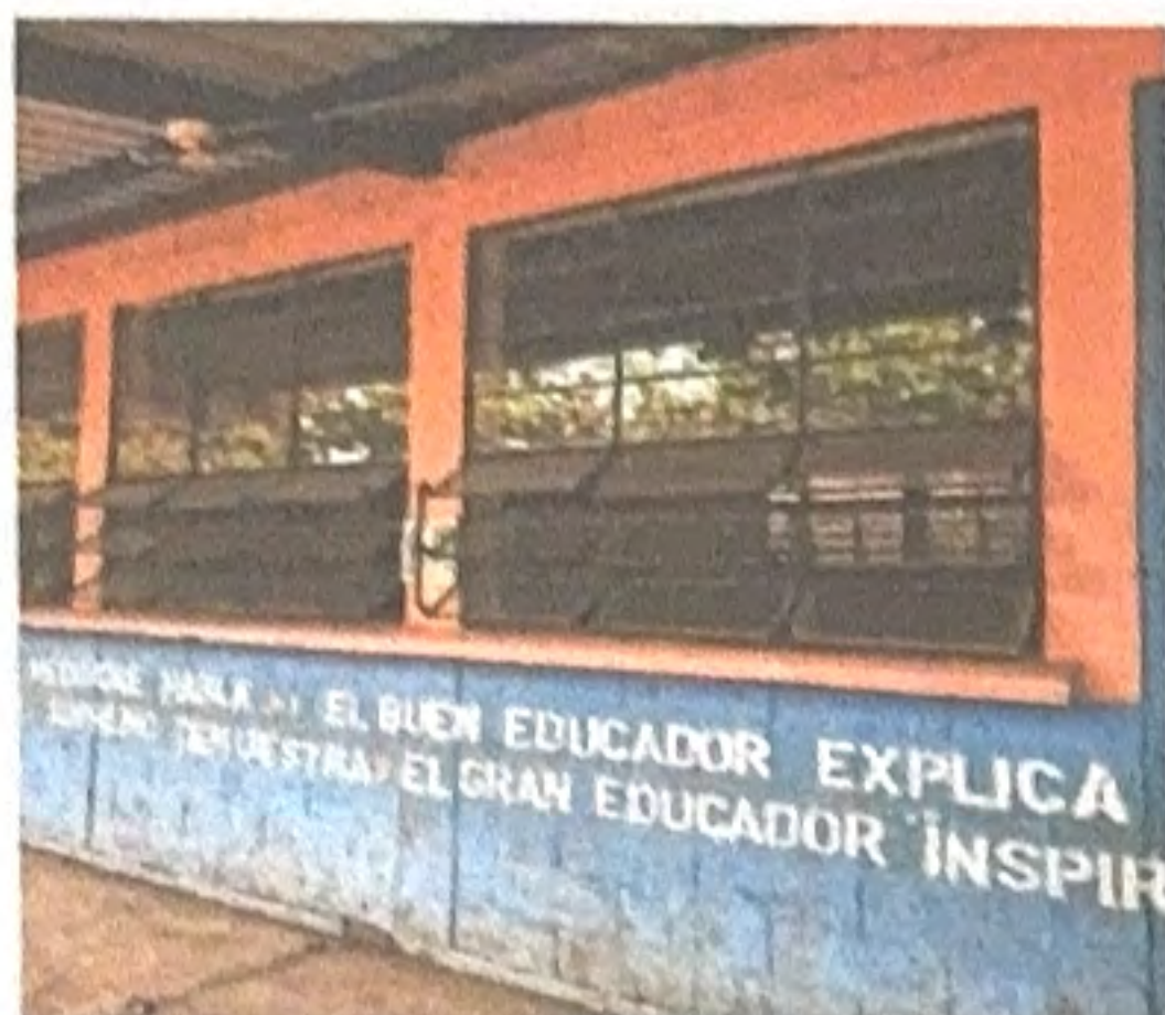
Foto 1: Se observa el mal estado de la estructura de las ventanas
