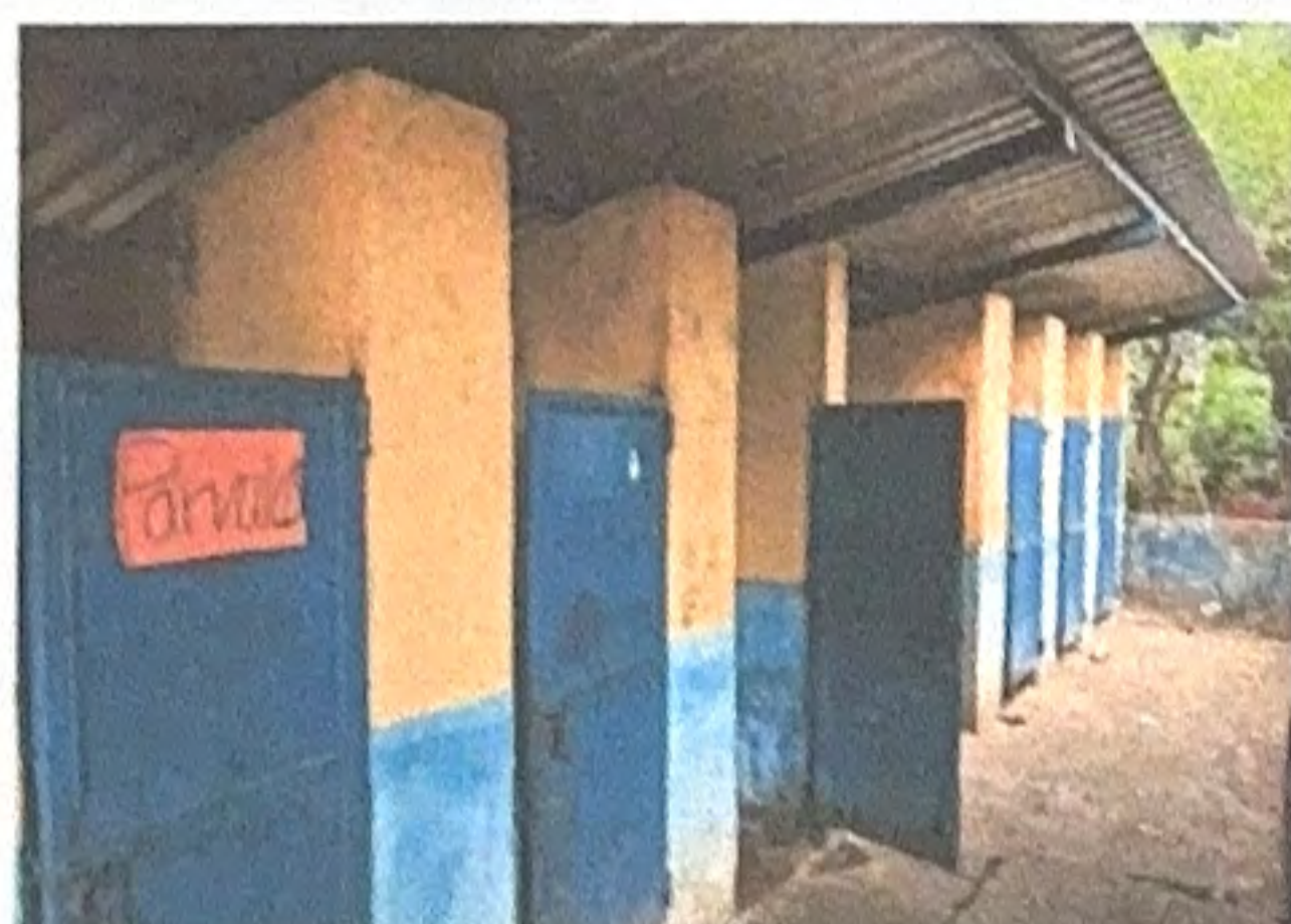
Foto 5: Se observa el descuido del área de los sanitarios
