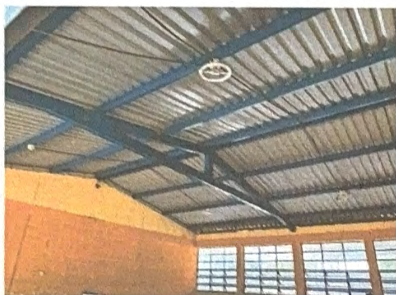
Foto 3: Se observa que las aulas carecen de fluido eléctrico
