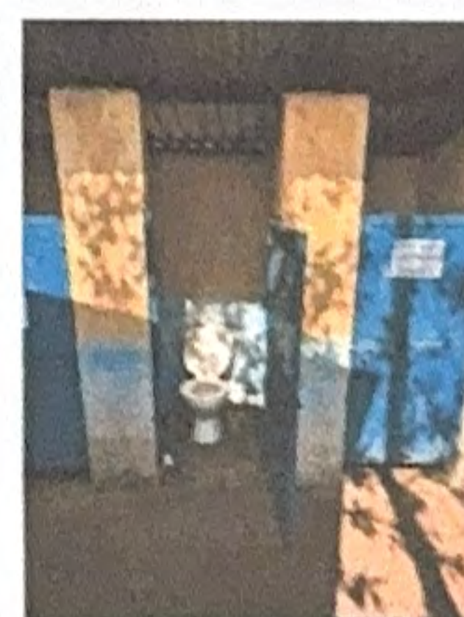
Foto 4: Se observa los inodoros en mal estado, urge darles mantenimiento.
