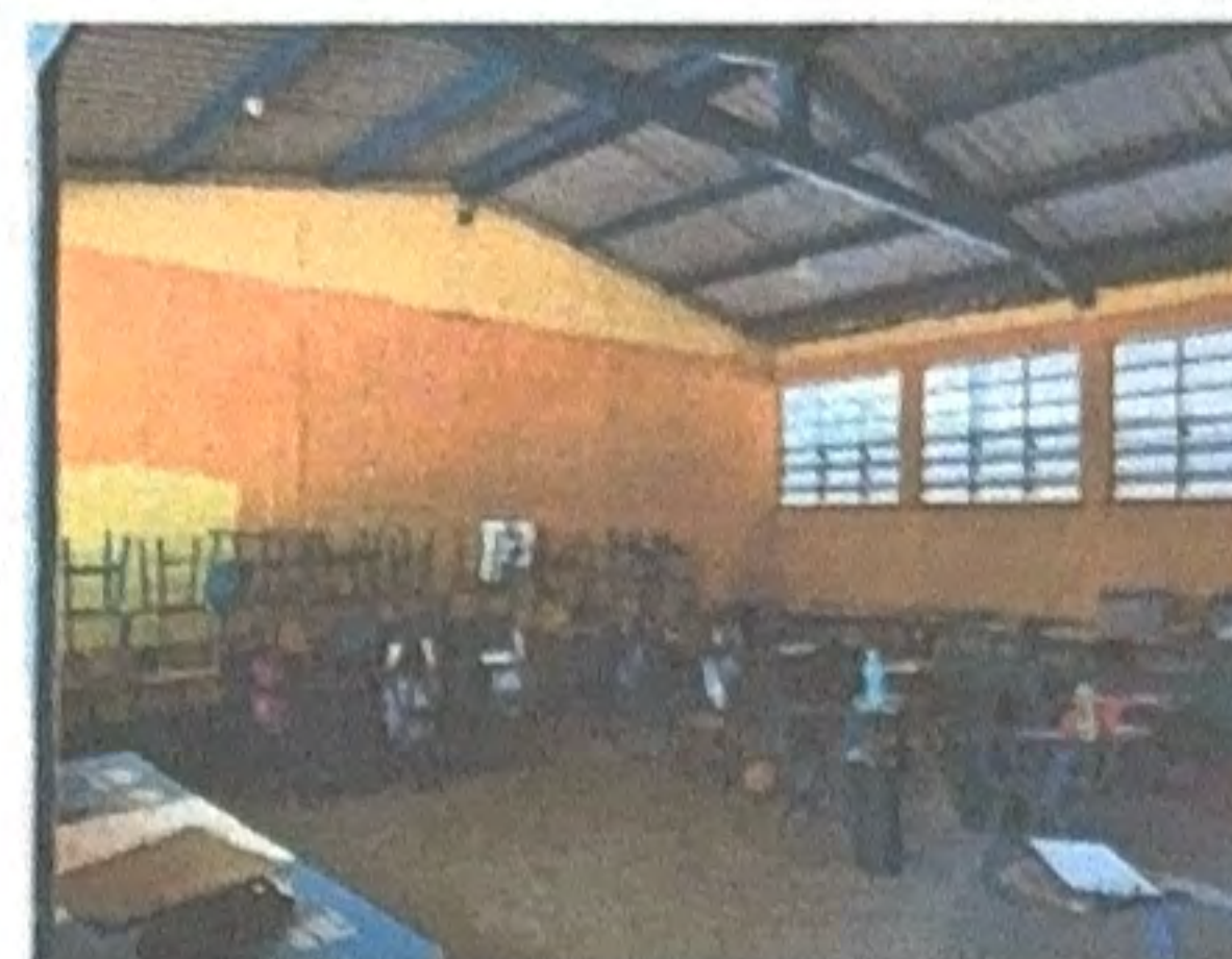
Foto 2: Se observa la necesidad de aplicar pintura y piso cerámico a las aulas
