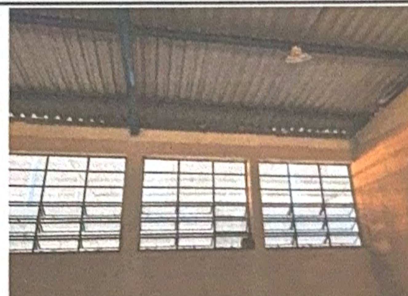
Foto 4: Es necesario suministrar un modulo metálico para que ya no ingresen mucho animal silvestre a las aulas
