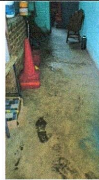
Foto 8: Piso actual de la bodega para artículos de la clase de educación física y otros enseres que requiere instalación de piso cerámico
