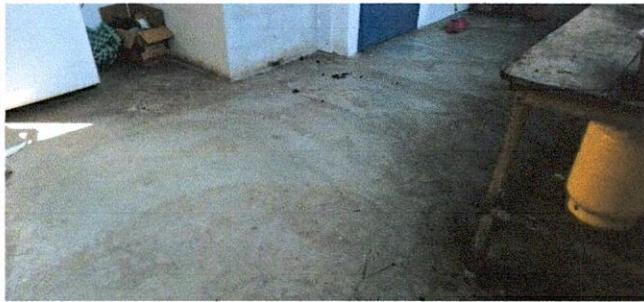
Foto 7: Piso actual de la cocina donde se requiere la instalación de piso cerámico para facilitar la limpieza
