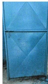
Foto 4: Estado de las puertas de los baños que necesitan mantenimiento para prolongar su vida útil
