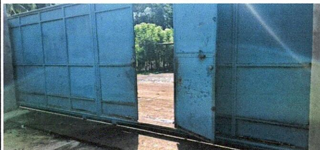
Foto 1: Se observa el mal estado de la estructura del portón y la chapa en mal estado
