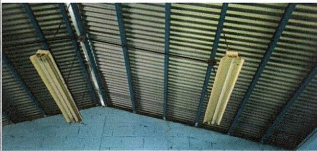
Foto 9: Instalación eléctrica para iluminación en mal estado que necesitan ser reemplazados.
