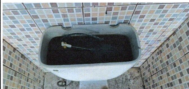
Foto 3: Los accesorios de los inodoros que deben ser cambiados para que entren en funcionamiento nuevamente
