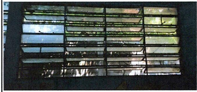
Foto 10: Ventanas que requieren ser reemplazados por ventanas de PVC + vidrio
