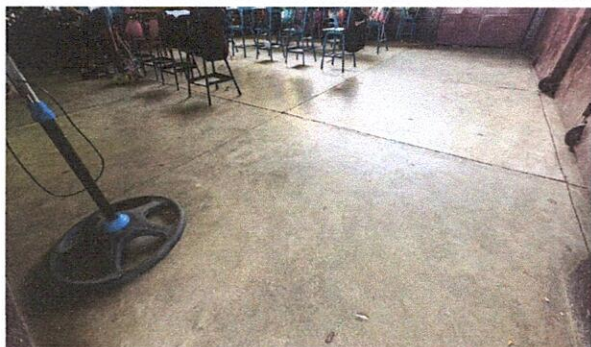
Foto 1: Se observa que las aulas no cuentan con piso cerámico.
