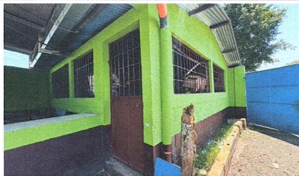
Foto 2: Se observa que las aulas y dirección requieren de pintura.
